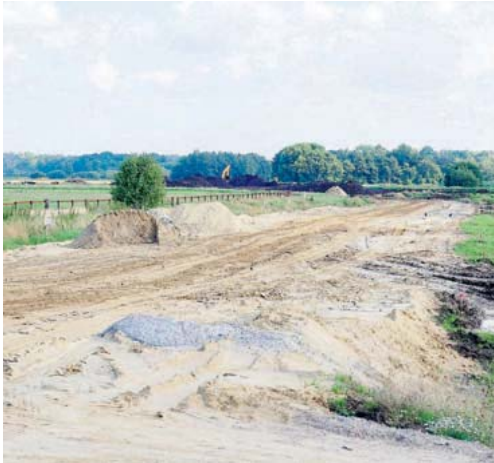
In erster Linie belastet der Bau der Ortsentlastungsstraße den Etat der Gemeinde, betont der Bürgermeister. Leider werde das auch von der FDP nicht wahrgenommen. Unser Bild zeigt übrigens die baulichen Aktivitäten beim fünften Abschnitt.
